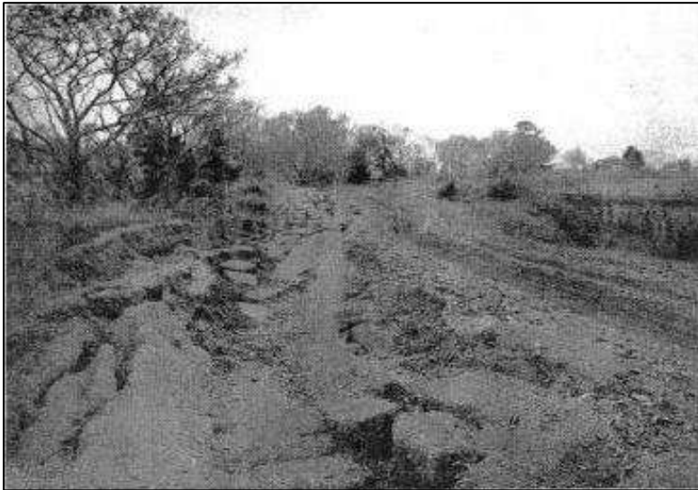
金目川堤防の地割れ
