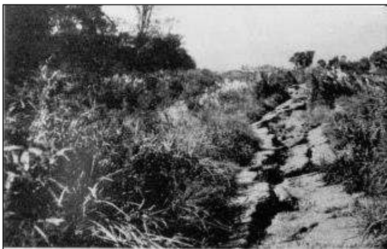
鈴川堤防の地割れ
